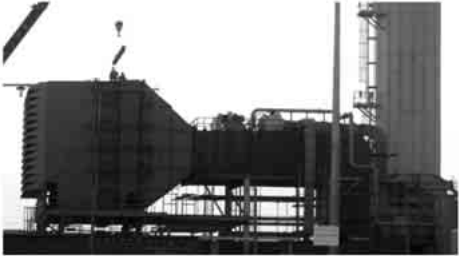
Figura 9b Batería de enfriamiento ya instalada
