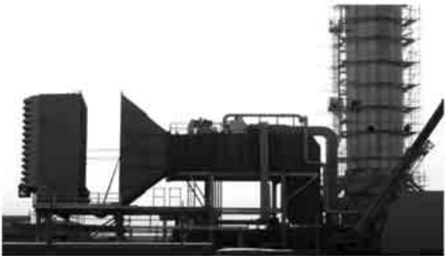
Figura 9a Separación de la caja de filtros de la turbina para insertar la batería de enfriamiento
